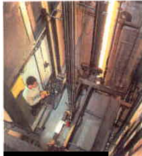
Hissin ajomukavuuden kannalta avainasemassa on kuilun laitteiden ja ovikoneiston synkronoitu yhteistoiminta. (Chicago, USA)
